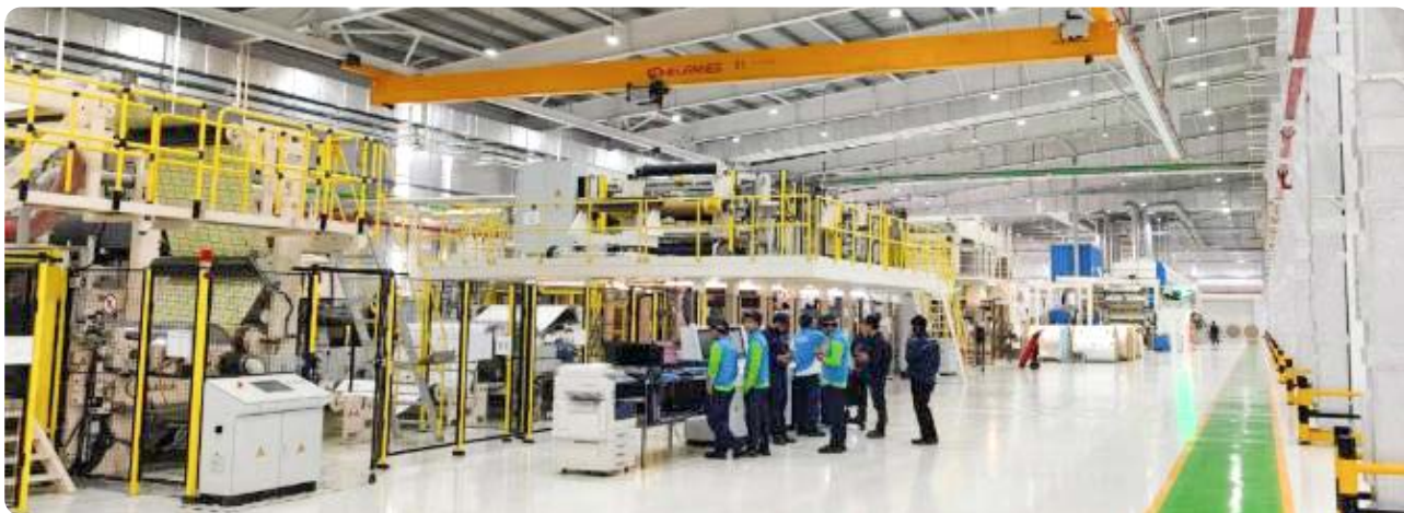
生产区带自动开关的 LED 照明设备
